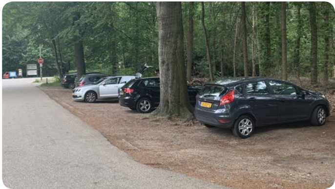
Afb. 5.6 Ondergrond parkeervakken voldoet niet (modderig in de winter).
